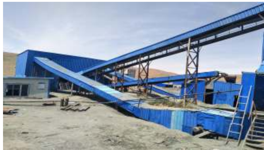
干选 1 线封闭式皮带运输廊道
