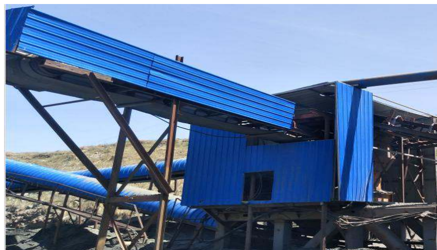
干选 2 线锤式破碎机封闭设置
