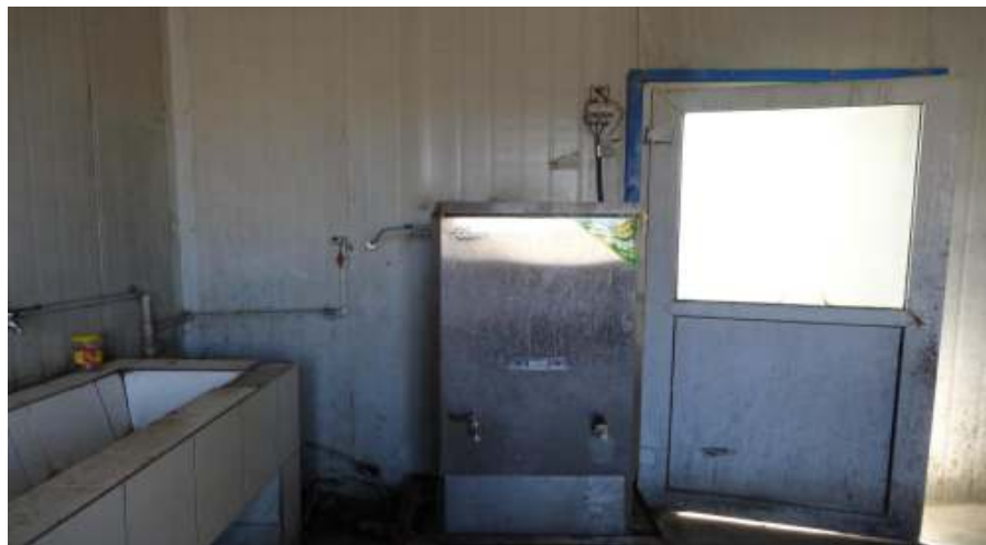
办公区电热水器
