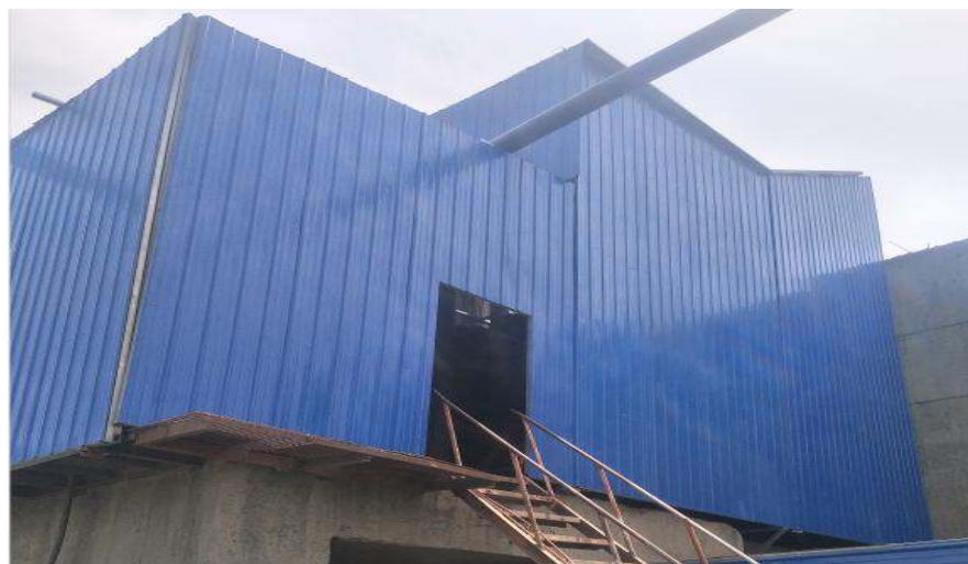
干选 2 线颞式破碎机处封闭
